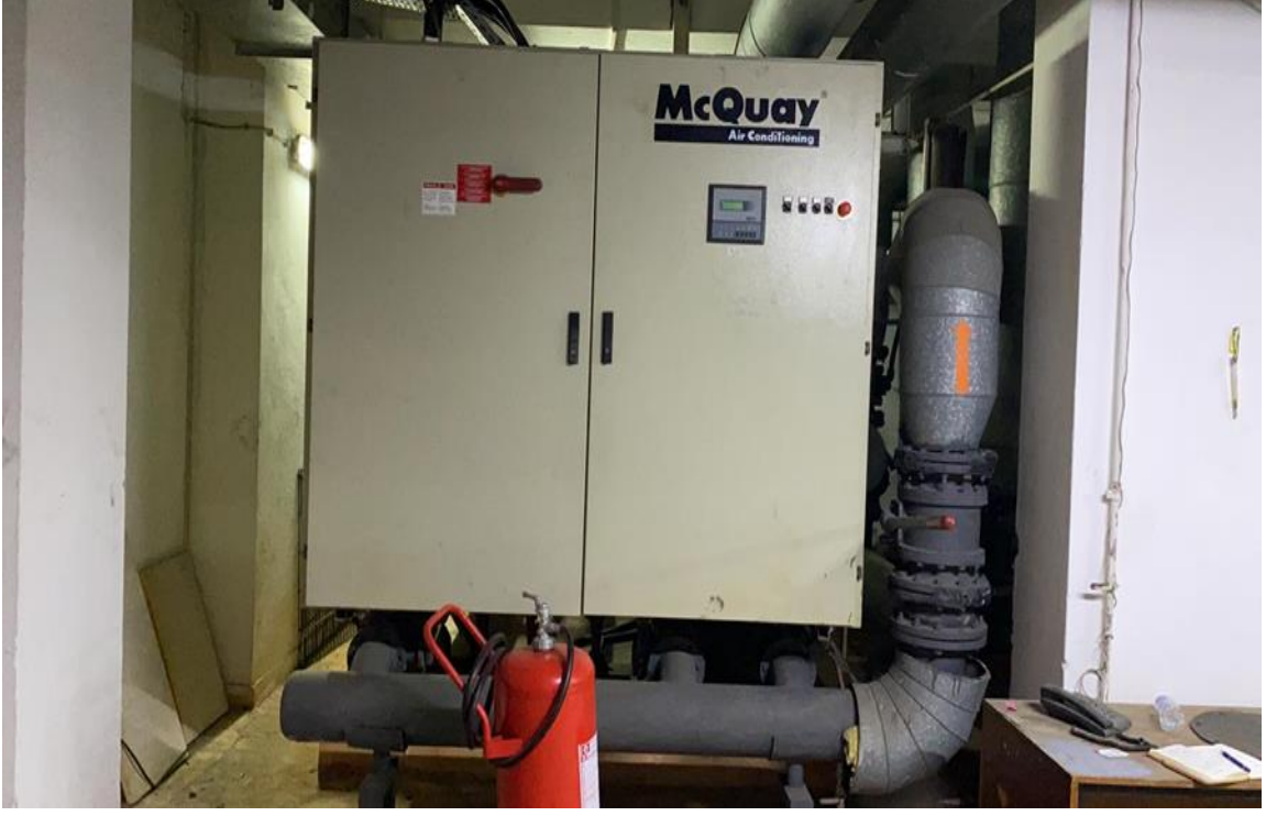
Fotoğraf 4. Chiller Grupları
