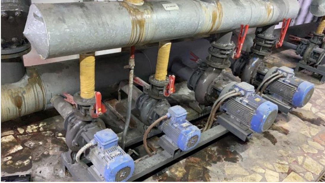
Fotoğraf 6. FCU Isıtma Soğutma Pompaları Genel Görünüm
