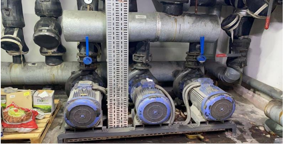
Fotoğraf 5. Soğutma Dönüş Pompaları
