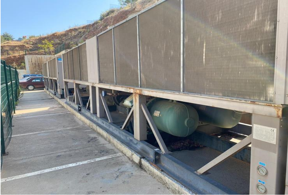
Fotoğraf 4. Chiller Grupları
